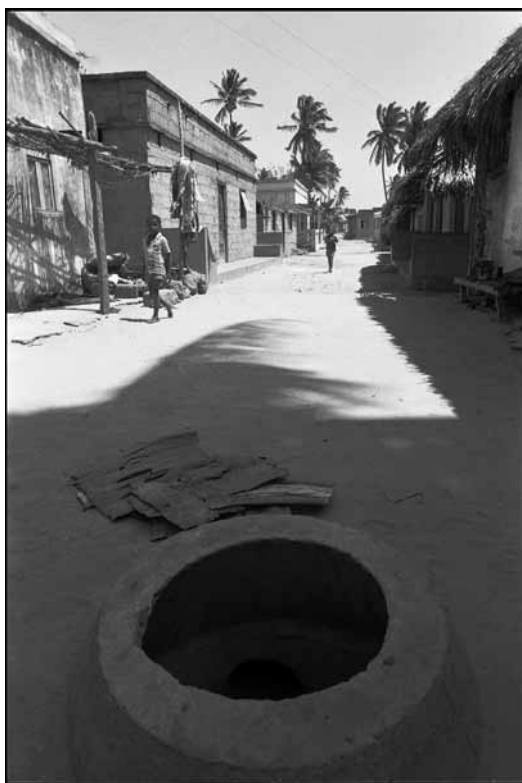
Fotografia 57 e 58: "... está montado um sistema de recolha e escoamento de águas pluviais que não funciona..." (Citação da página 99).
